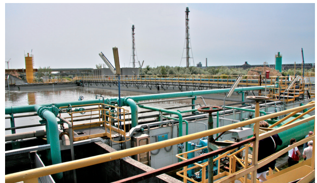
Impianto depurazione Fusina
