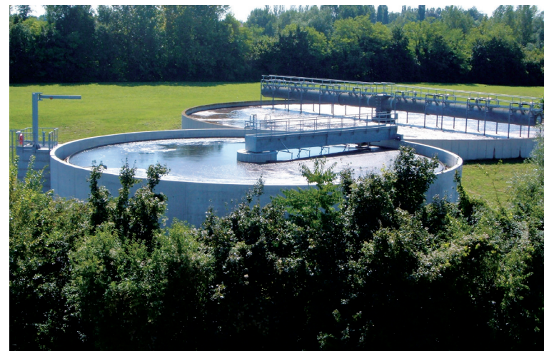
Impianto depurazione Carbonera - ATS
